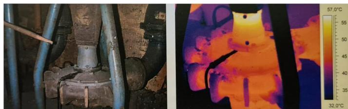
Figura 2 - Imagem apresentando possível problema no mancal de bomba
