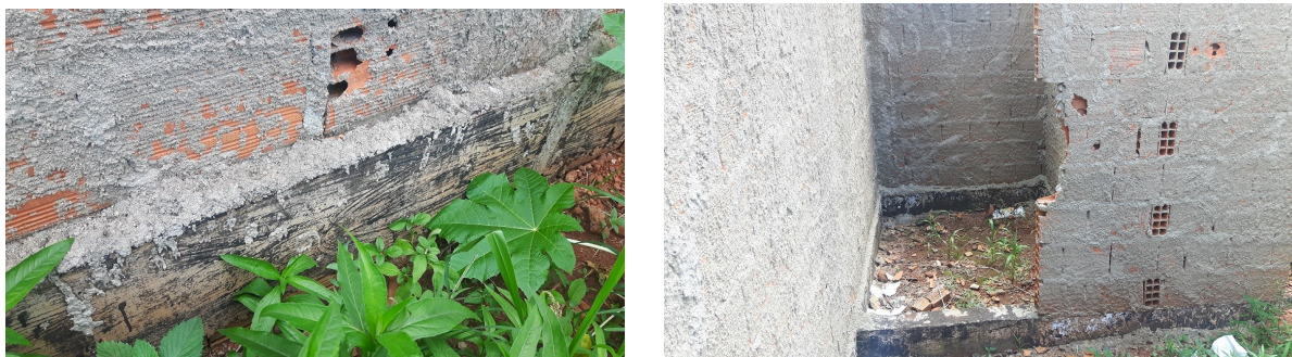
Vigas baldrame expostas com impermeabilização danificada
