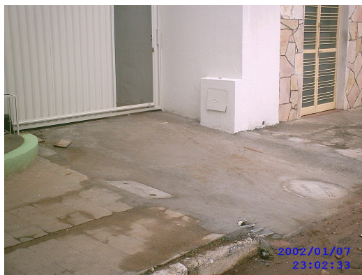
Desnível em relação à calçada limítrofe
